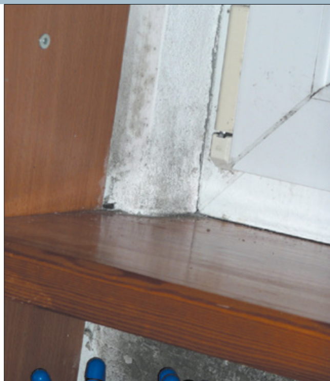
Obecność grzybów pleśniowych jest skutkiem występowania kondensacji wilgoci na powierzchni przegrody
