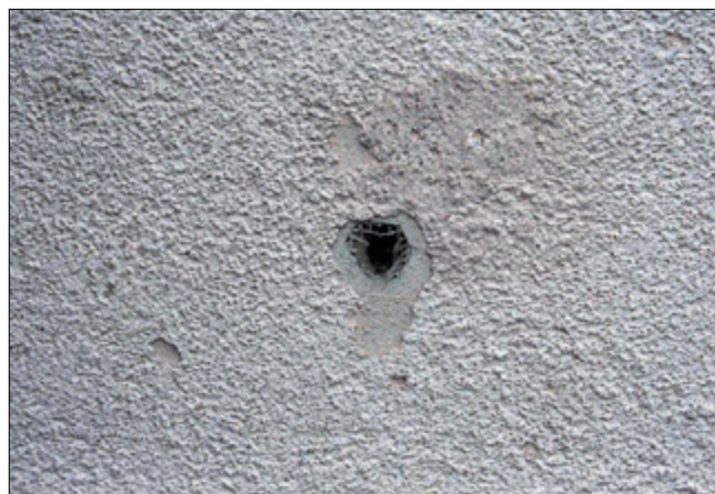
Uszkodzenie mechaniczne spowodowane przez uderzenie twardym przedmiotem
