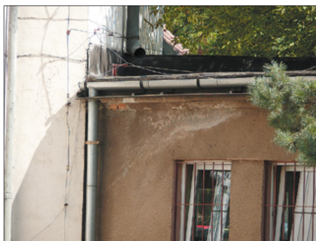
Zniszczenia na skutek oddziaływania wód opadowych Rys. M. Rokiel
