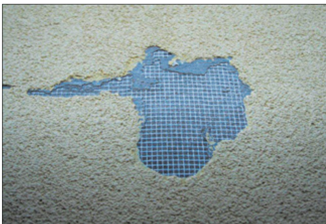
Odspojenie w warstwie zbrojonej
