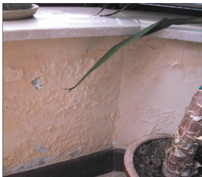
Skutki braku izolacji pionowej od strony wewnętrznej w budynku niepodpiwniczonym oraz przecieki na skutek błędów w obsadzeniu okien i parapetów Fot. M. Rokiel
