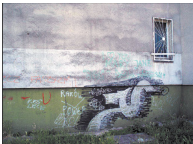
Graffiti na elewacji
