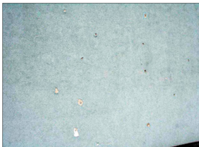
Uszkodzenia spowodowane przez gradobicie
