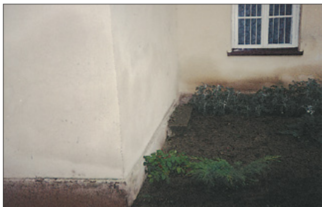
Przyczyną zawilgocenia budynku może być nawet ogródek Rys. M. Rokiel
