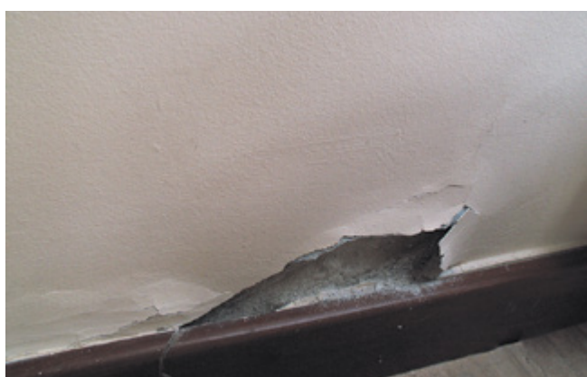
Skutki braku szczelności połączenia izolacji poziomej na ławach i izolacji podposadzkowej
