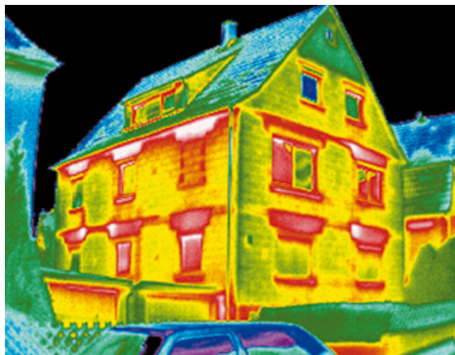
Utrata ciepła przez źle zainstalowane rolety
