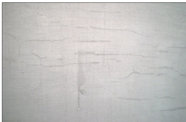
Pęknięcia na warstwie zbrojonej
