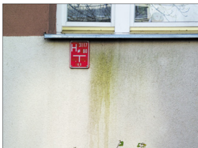
Porażenie biologiczne wyprawy tynkarskiej w miejscu występowania trwałego zacieku spod obróbki blacharskiej podokiennika
