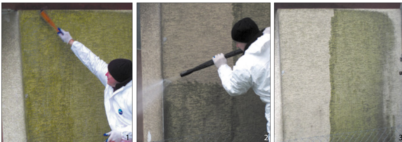
Czyszczenie mechaniczne ocieplonej elewacji zasiedlonej glonami: 1 – wstępne mycie elewacji i/lub nakładanie środka do sanityzacji; 2 – mycie elewacji pod ciśnieniem; 3 – efekt czyszczenia – po lewej stronie część ściany po zabiegach, po prawej – część nieoczyszczona Fot. archiwum SSO
