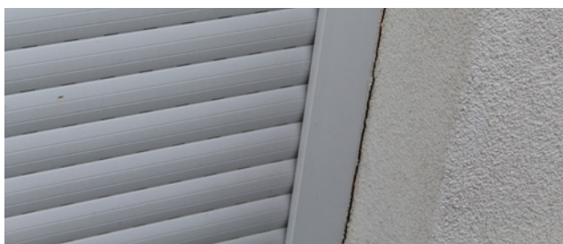
Fot. 2b. Szczelina na styku ościeżnicy i systemu ociepleń
