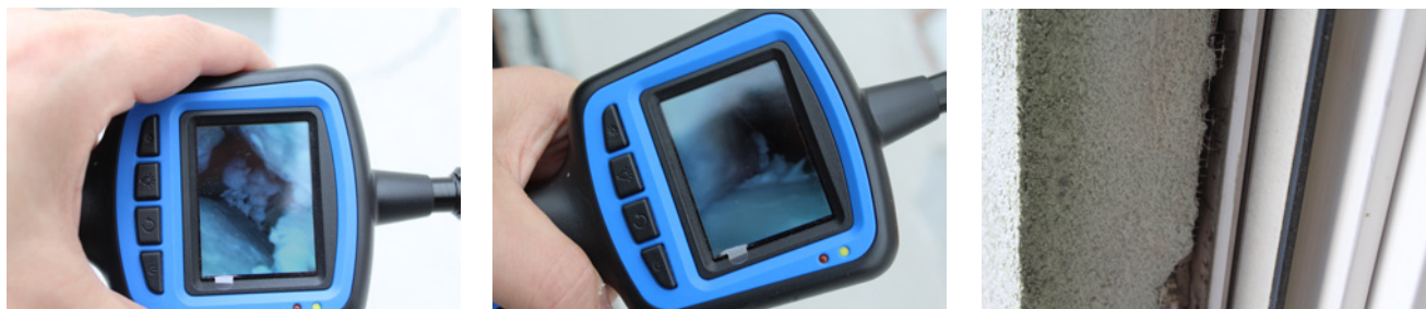
Fot.1a, 1b, 2a Stwierdzony brak paska obwodowego (ogłędziny kamerą endoskopową oraz ogłędziny ościeży) jest przyczynkiem do demontażu systemu ociepleń
