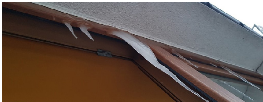
Fot. 6. Przyczynę do wykonania przeglądu incydentalnego i stosownej ekspertyzy
