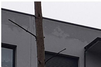
Fot. 9. Obszar przy dachu może mieć zasadniczy wpływ na trwałość eksploatacyjną ocieplenia
