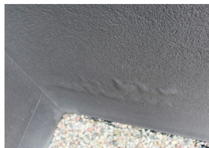
Fot. 8b. Naprawa takich mankamentów powinna być jak najszybsza, pozostawienie istniejącego „status quo” prowadzi do zarysowań i spękań tynku a w konsekwencji do zawilgacania systemu ETICS
