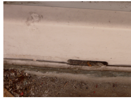
Fot. 10. Zbyt nisko obsadzone drzwi balkonowe. Opis w tekście /fot: autor/
