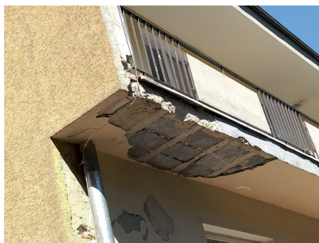
Fot. 2. Dla takiego „rozwiązania konstrukcyjnego” przed wykonaniem jakichkolwiek prac naprawczych wymagana jest ekspertyza
