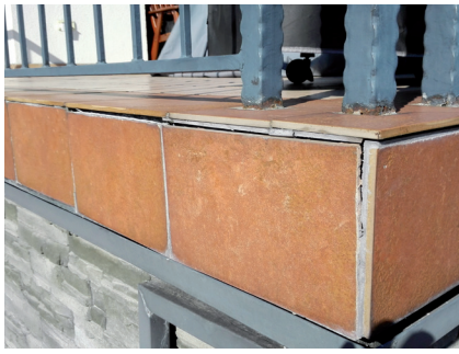
Fot. 8. Okapu nie wolno wykonywać w taki sposób. Opis w tekście /fot: Renoplast/
