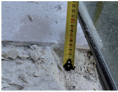
Fot. 9. Warstwa kleju pod płytką w strefie okapu. Izolacja zespolona była wykonana poprawnie, jednak grubość warstwy kleju wynosiła ok. 2 cm. Klej mokry /fot: autor/
