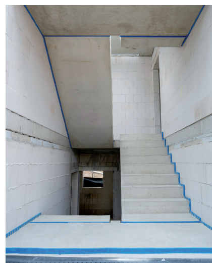
Fot. 3. Klatka schodowa z biegami i spocznikami prefabrykowanymi z systemem izolacji akustycznej;
