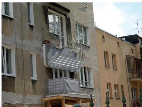
Fot. 1. Awaria balkonu
